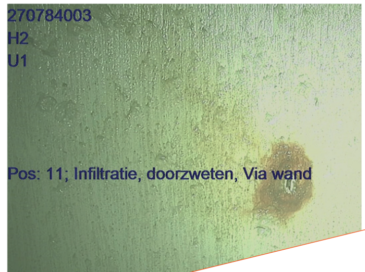
Binnenkant rioolbuis (bruine plek)
