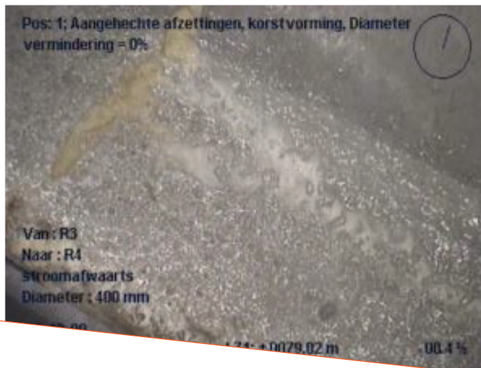
Binnenkant rioolbuis (witte plek)
