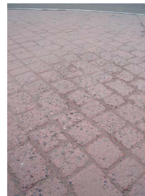
Afschilfering aan het oppervlak van een gekleurd beton blootgesteld aan dooizouten.
