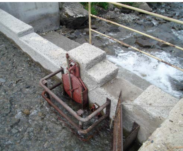
Bouwdelen waarvan het beton het meest met water is verzadigd, vertonen het snelst schade: het betreft hetzij bouwdelen die functioneel in aanraking komen met het water, hetzij bouwdelen die vanwege hun vorm het regenwater vasthouden (horizontale vlakken)
