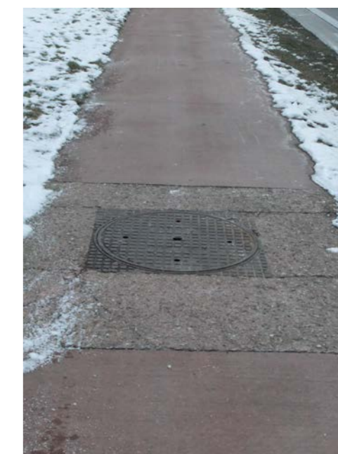
Fietspad aangelegd in 2001 en in uitstekende staat, maar met een aangetast gedeelte ter hoogte van een inspectieput omwille van een minderwaardige betonsamenstelling.
