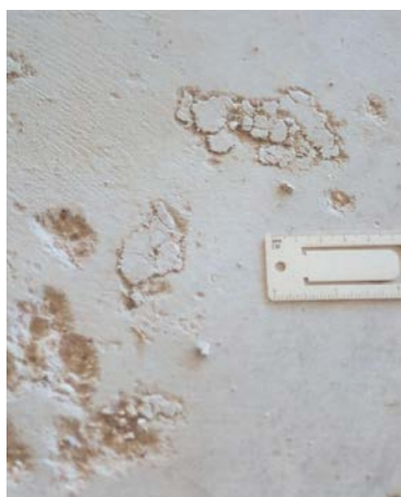
- afschilfering van het oppervlak van een vloer van gepolijst beton
