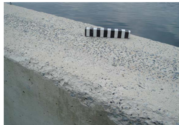
Vorstschade met dooizouten op de bovenkant van een betonwand van een bezinkingsbekken van een waterzuiveringsinstallatie. Bij te veel opstijging van mortel en cementmelk is het bovenvlak van verticale betonwanden bijzonder kwetsbaar. Het kan nuttig zijn ze af te borstelen of te verrijken door ze te bestrooien met een droog mengsel (1 deel cement – 1 deel zand) en ze vervolgens mechanisch of handmatig krachtig af te strijken.
