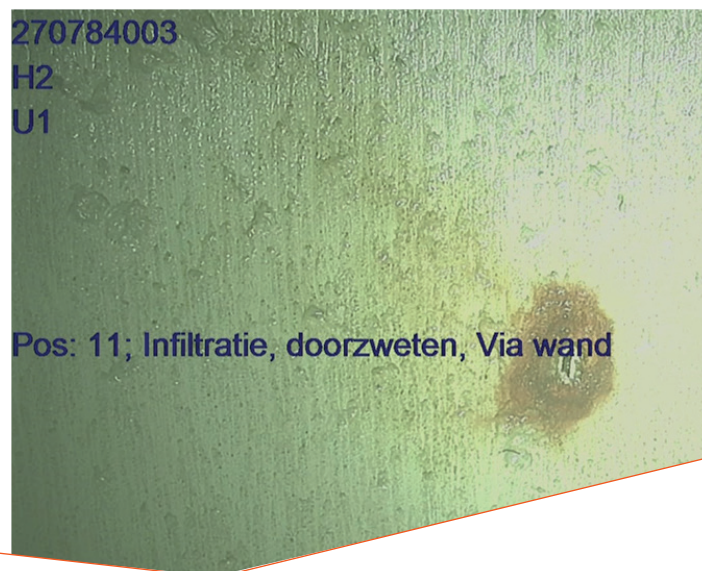
Binnenkant rioolbuis (bruine plek)
