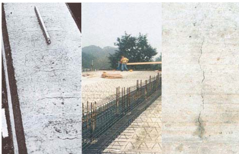
Links: zettingsscheuren ter plaatse van wapening, bovenzijde wand (type A)
