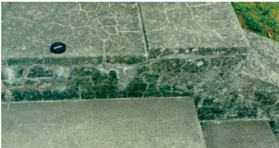
ASR-schade aan trap
