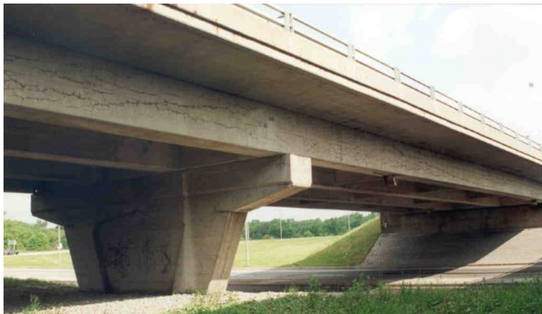
ASR in een viaduct, zichtbaar als craquelé
